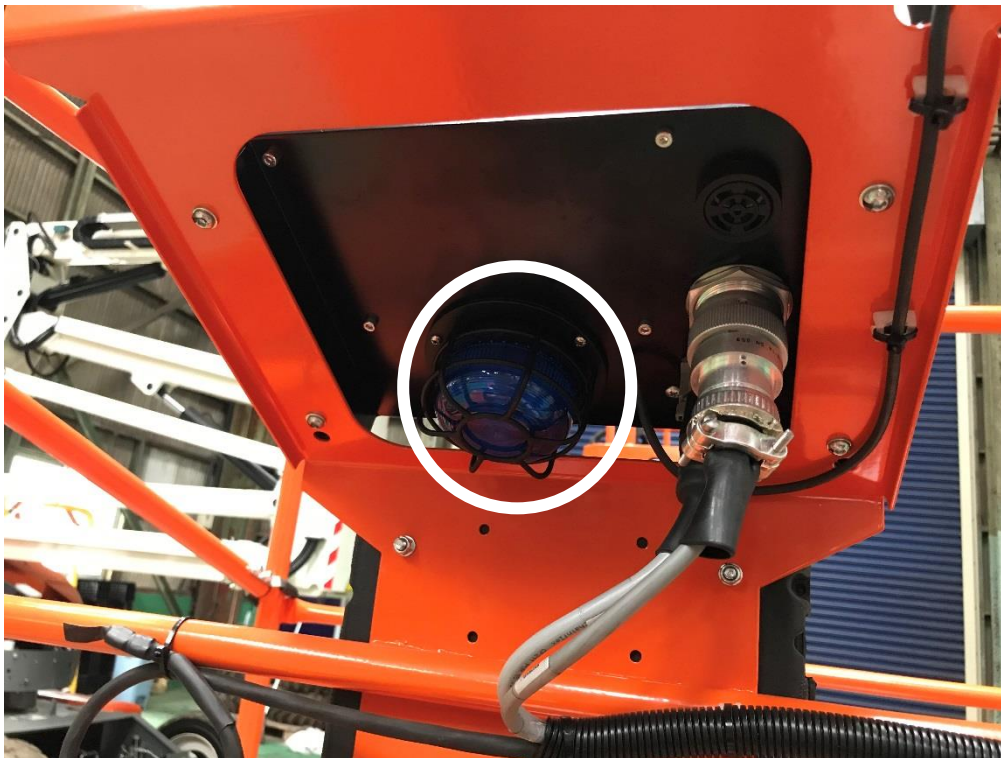
※上部操作盤下の青いフラッシュライト
