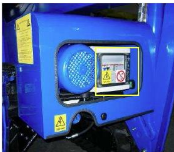
操作盤は電圧 100220 V がかかっています 要注意
