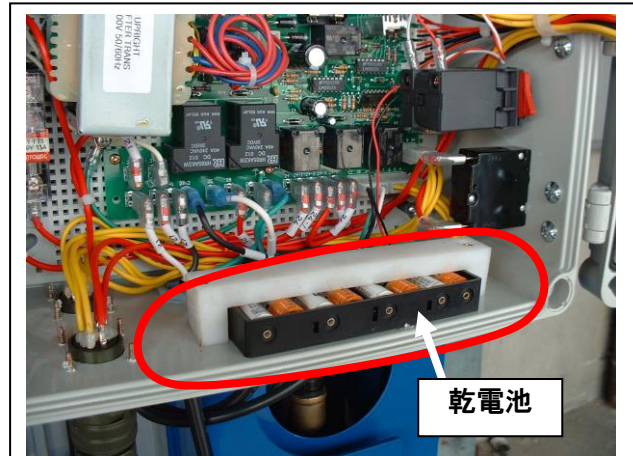
図13:本体側操作盤 内部
