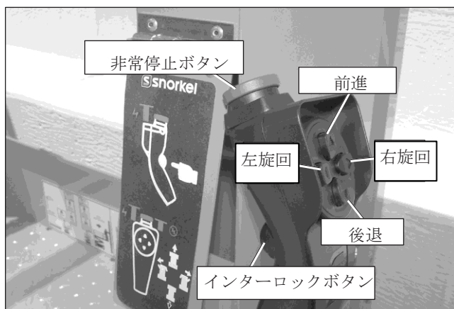
図9.3 - 積み込み操作盤
