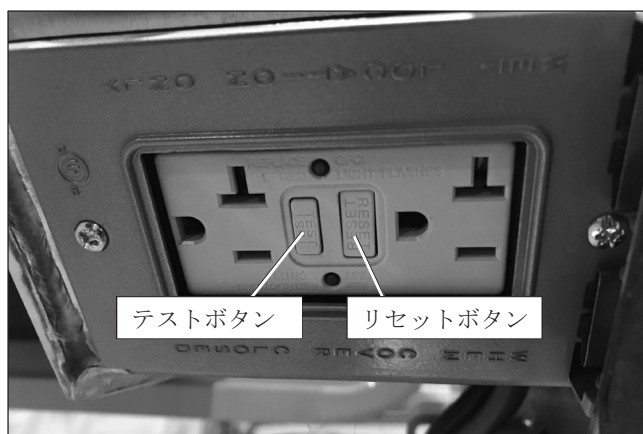
図8.17 - 電源コンセント
